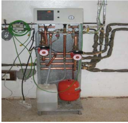
Fig. 2: Module hydraulique de transfert
