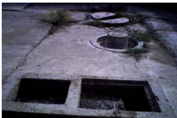
Vue 2: Digesteur pilote rural
