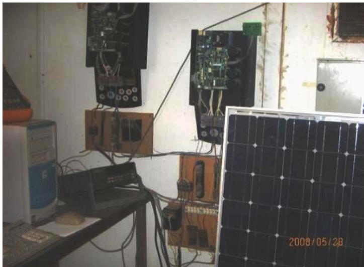
Fig. 1: Banc d'essai de caractérisation des systèmes de pompage PV
