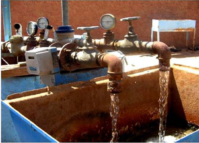
Fig. 2: Puits et instruments de mesure (capteurs de débit, transmetteur pression)
