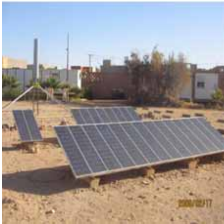
Fig. 5: Vue générale d'un générateur photovoltaïque
