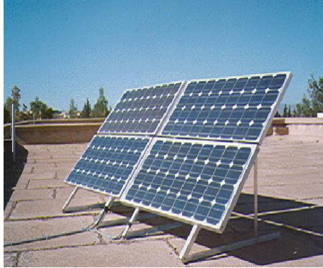
Fig. 11: Panneaux photovoltaïques SP75 installés à la Faculté des Sciences d'Oujda
