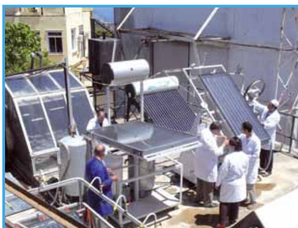
Vue générale de la plate-forme d'expérimentation des capteurs solaires thermiques et des chauffe-eau solaires au CDER, Bouzaréah - Alger
