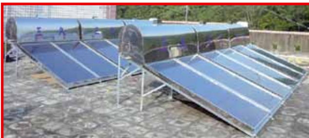
Figure 1 . Installation d'un chauffe eau solaire collectif en matière anticorrosion [1]
