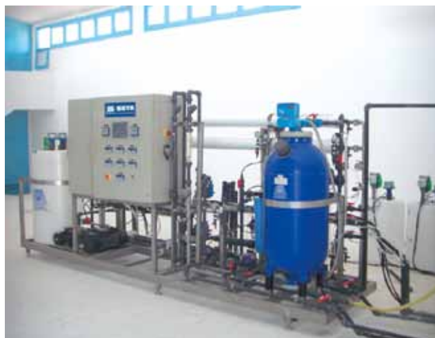
Figure 2. Unité d'osmose inverse
