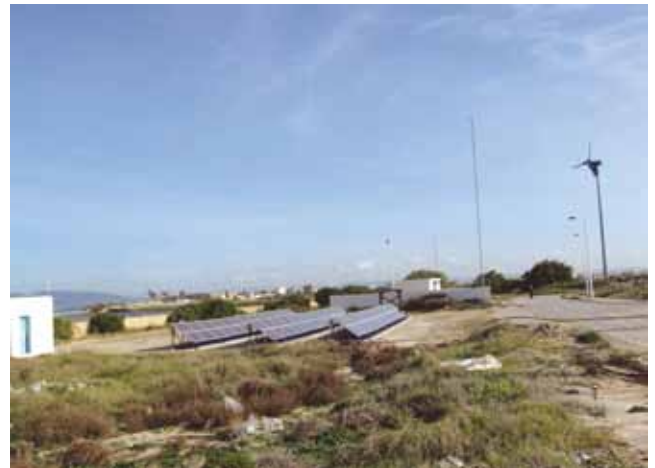
Figure 5 . Vue de l'installation - Bordj-Cedria
