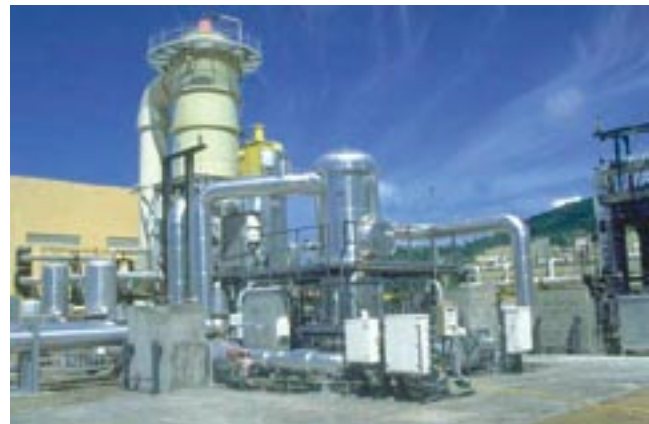
Fig.5 : Centrale de Bouillante en Guadeloupe, France [2]
