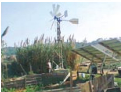
L'éolienne de pompage multipales au service de l'agriculture
