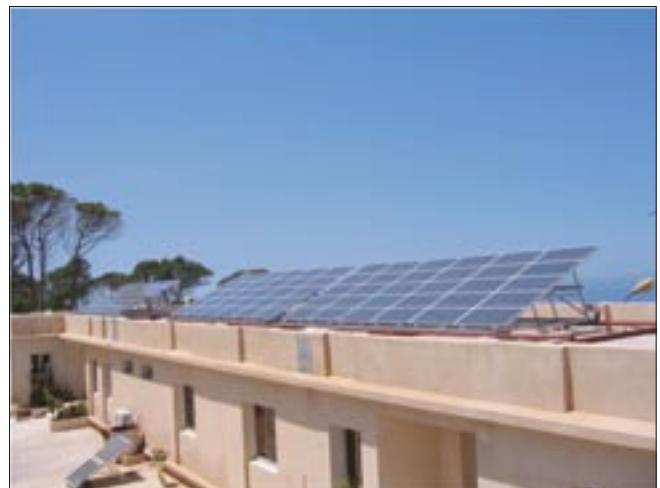
Les trois champs de modules PV constituant le générateur PV
