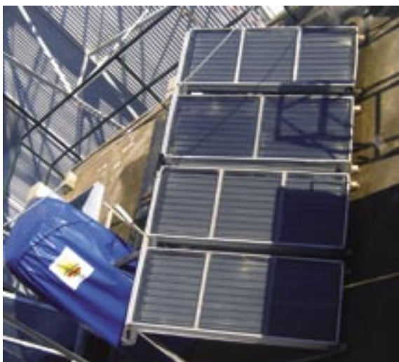
Différents composants de l'installation
