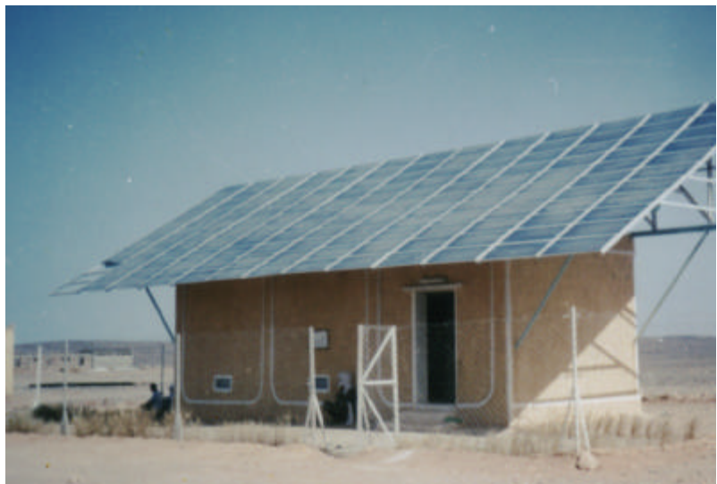
Générateur photovoltaïque pour l'électrification village Fedhoune Willaya Illizi
