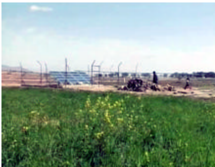
pompage photovoltaïque pour l'irrigation Merije - Willayat tebessa
