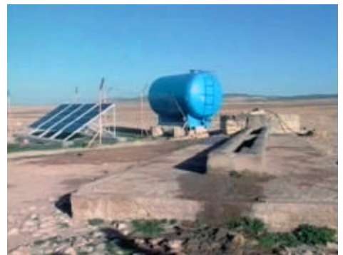
système de pompage photovoltaïque
