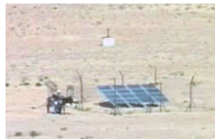
pompage photovoltaïque Est-Batna
