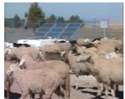
pompage photovoltaïque Bir Ramla - Willaya Djelfa
