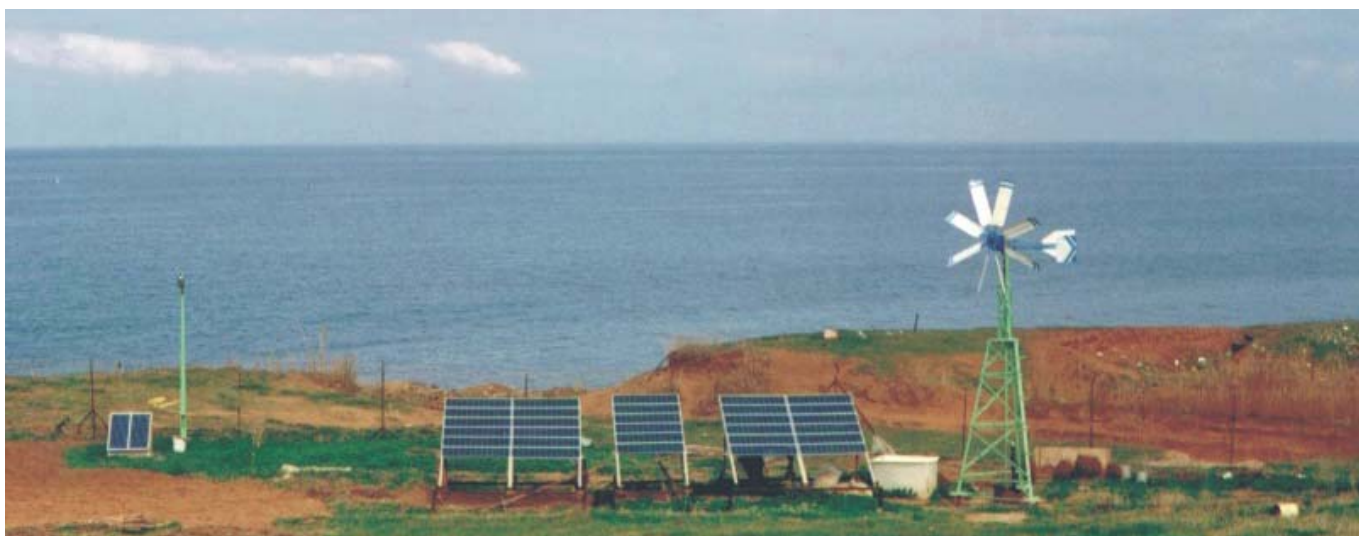
Système hybride pour le pompage de l'eau - Bou-Ismaïl - Tipaza
