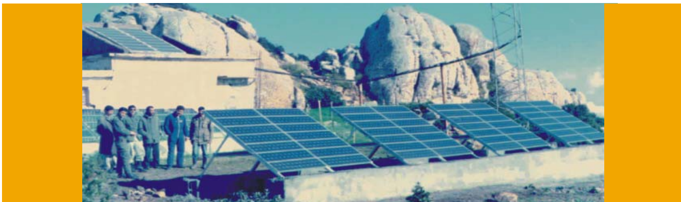
Système photovoltaïque pour télécommunication - W. Bordj Bou-Arreidj
