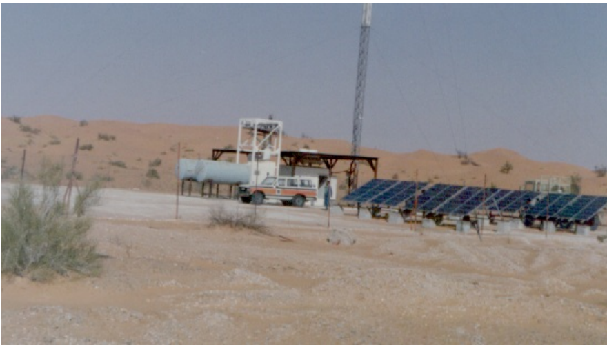
Système photovoltaïque pour la surveillance d'une station de pompage de pétrole Hassi-R'mel
