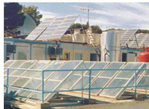
Installation de chauffage solaire collectif 1500 litres CDER bouzareah
