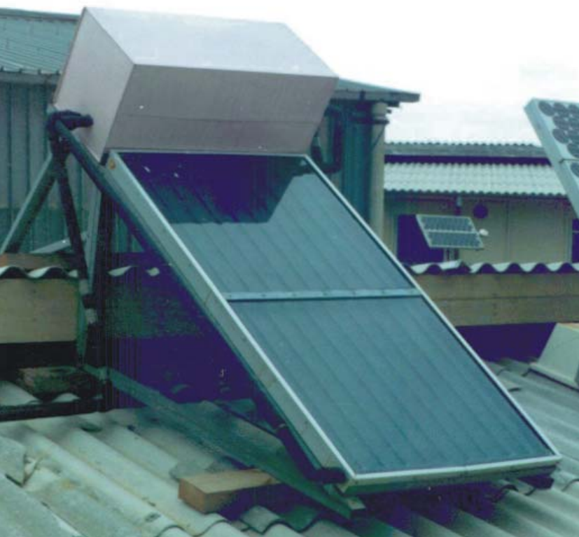
Chauffe-eau solaire individuel 110 litres - C.D.E.R bouzareah
