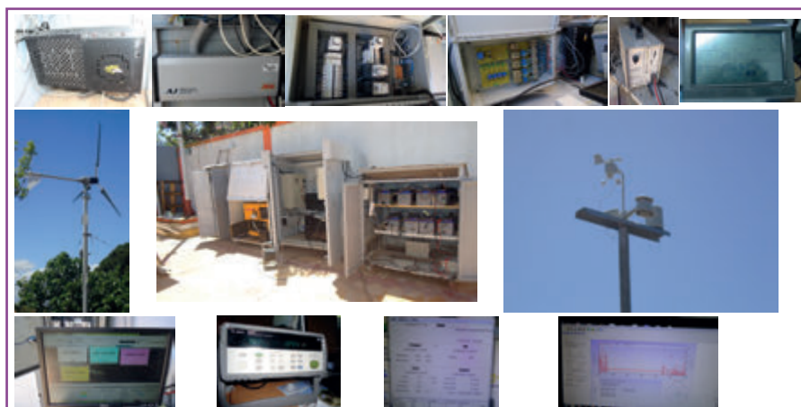
Figure 1: Système Eolien/Diesel/Batteries installé au CDER (3).
