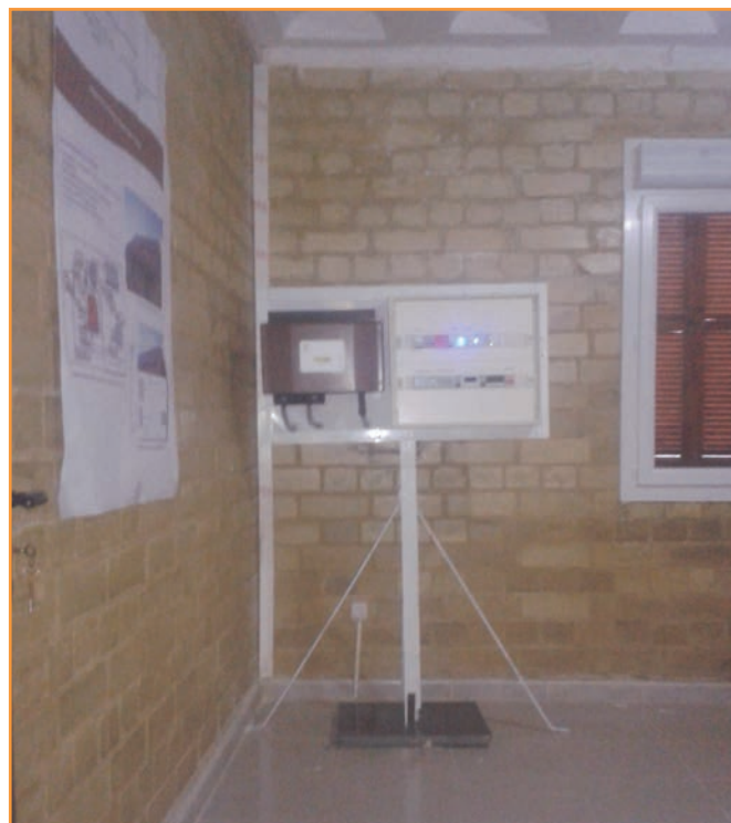
Figure 4: Onduleur et armoire de raccordement électrique et de commande
