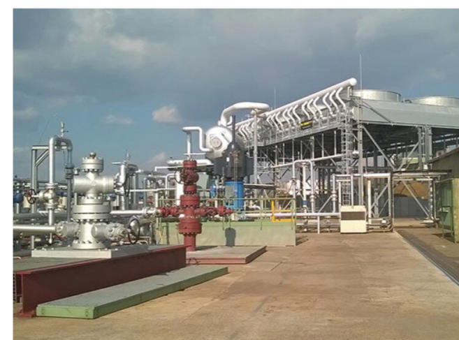
Figure 10. Centrale géothermique à fluide binaire (ORC), Alsace, France [10].
